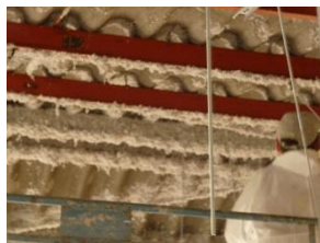
Photo, flocage de la charpente métallique. Le système électrique est transformé comme le chauffage, les sols seront
